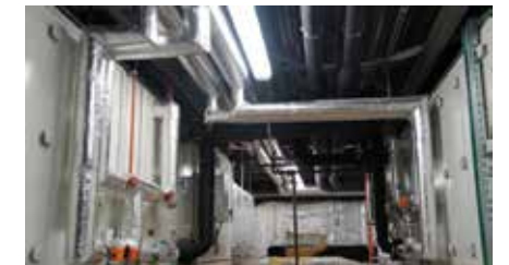
Samen met THV-partner Beltherm – verantwoordelijk voor de ventilatie – had EEG alle technieken onder haar hoede bij deze nieuwbouw.
